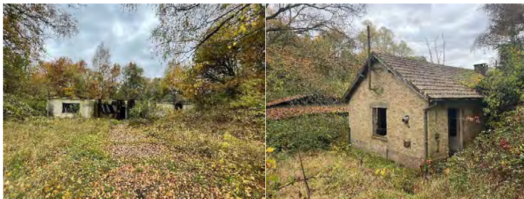
Plusieurs bâtiments sont présents sur le site. Inutilisés depuis de nombreuses années, ils présentent ponctuellement des dégradations.
