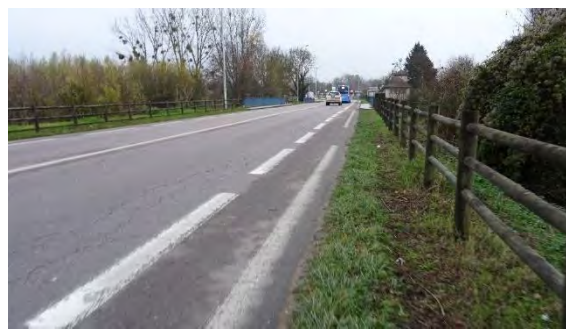
Figure 4 : Bande cyclable sur la RD 6015 longeant le site projet présent sur la droite.
